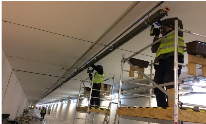
Rys. 12. Instalacja linii głównej PRL w tunelu akceleratora ESS.
